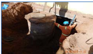
Trabajos de reparación en Edificio de Estadísticas, por socavamiento bajo losa Sala Eléctrica N°2.
