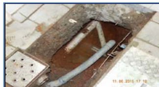
Filtración Red Agua Caliente en CAI
